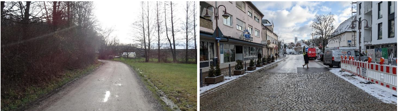
Abbildung 36: Links: Oberflächenbeschaffenheit für Basisnetz ausreichend, rechts: Oberflächenbeschaffenheit für Hauptnetz unzureichend
